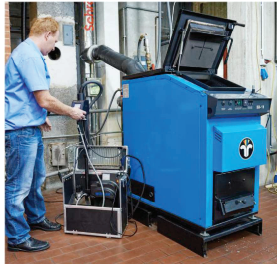
Abb. 4: Einsatz des mobilen Gesamtsystems an einem Scheitholzkessel
