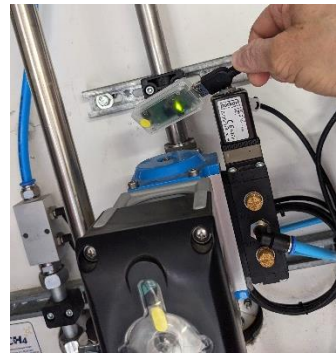
Abb. 15: Absuchen einer H_2 -Versorgungsleitung und Ventilen mit dem Sensorsystem zum Auffinden von Leckagen.
