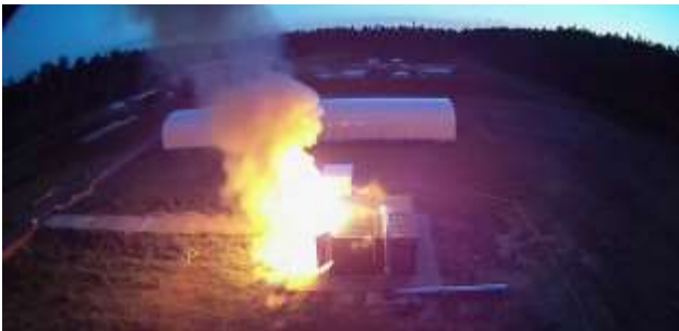
Abbildung 5 Thermisches Durchgehen durch Überladen eines 6,85kWh-Moduls [13].
