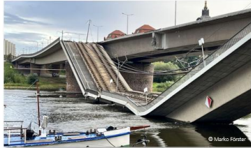
Dresden: Einsturz von Brückenzug C der Carolabrücke am 11.09.2024
