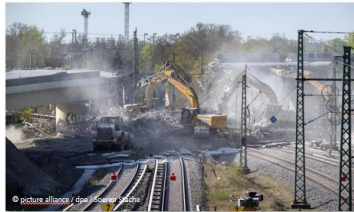
Berlin: Vollsperrung der sogenannten Ringbahnbrücke der Stadtautobahn A100 am 19.03.2025 wegen eines ausbreitenden Risses im Tragwerk.
