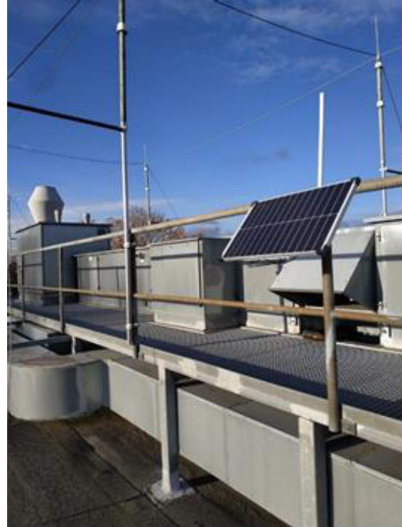
Abb. 1: Autarkes LoRaWAN-Gateway (Milesight SG50) mit leistungsstarker 9-dBi-Stubantenne (INBM – TUBAF Freiberg)
